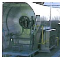
Термическая очистка вентиляционных цепи выбросов
