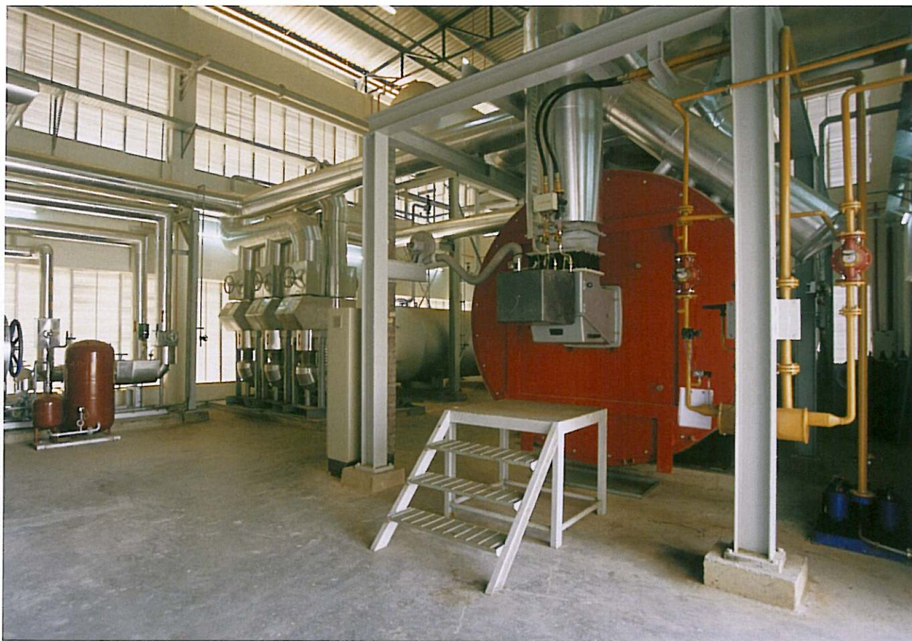
Термомасляный нагреватель с мощностью 10 МВт, для изготовления ДСП в Малайзии
