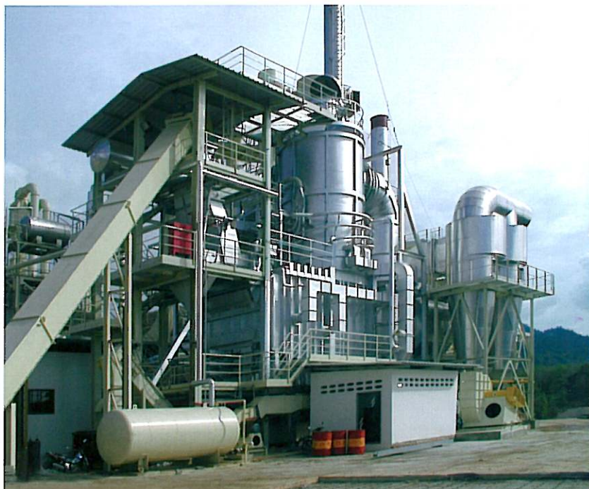
Установка по сжиганию твердого топлива, для шлифовальной пыли, мощностью 11 МВт, Тайланд
