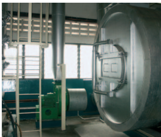
Horizontaler Erhitzer mit 10 MW Nettoleistung mit Verbrennungsluftvorwärmer, leichtölgefeuert. Einstiegstür an der Wendekammer zur Inspektion des Brennerraumes, Malaysia
