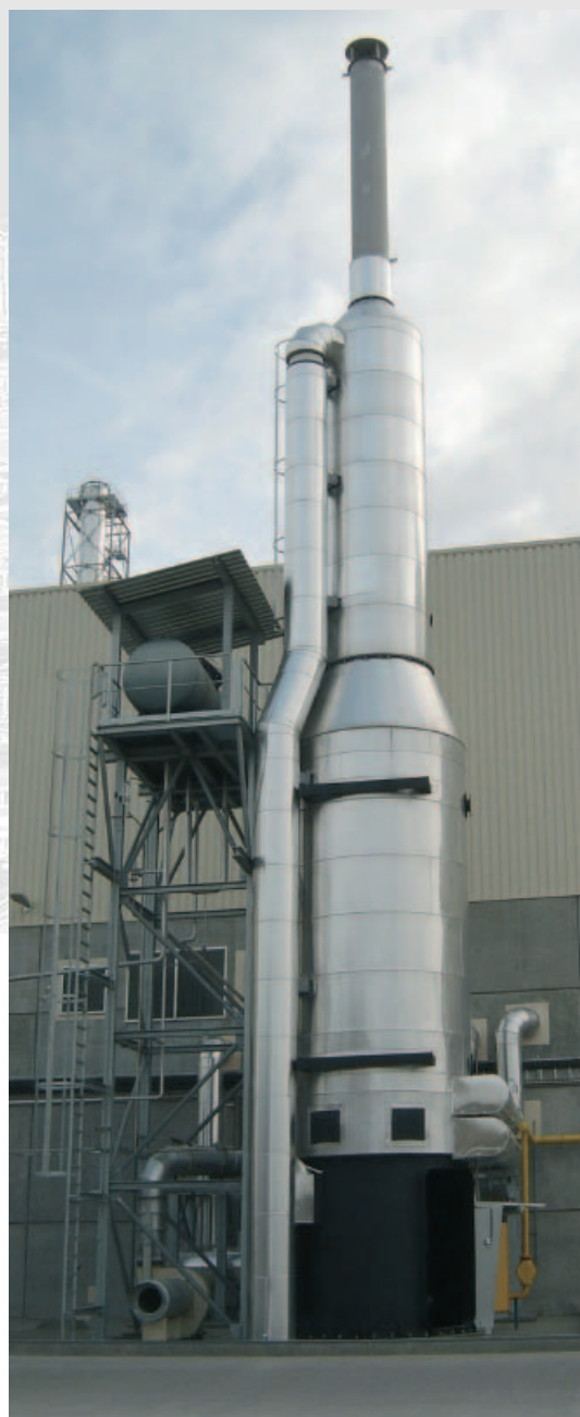
Vertikal aufgestellter Erhitzer Leistung: 9,6 MW mit aufgesetztem Verbrennungsluftvorwärmer und weiterführendem Kamin. Gesamthöhe: 25 m, erdgasbefeuert, zur Beheizung einer Spanplatten-Presse, Rumänien
