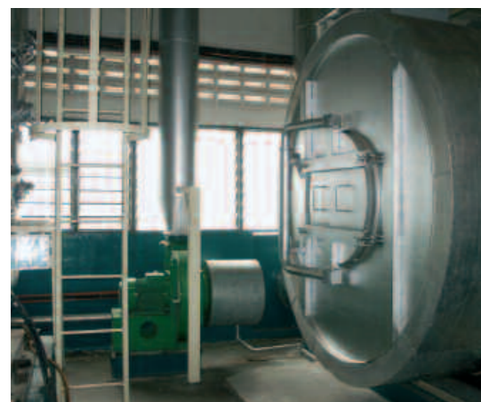
горизонтальный нагреватель мощностью 10MWt с подогревателем воздуха, сжигание лёгкого масла, оснащенный инспекционной дверцей в камере горения, Малайзия
