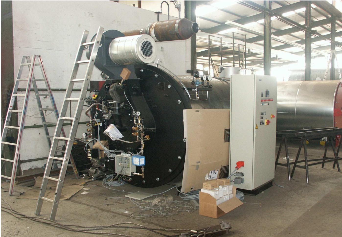
Erhitzer mit Saacke-Rotationbrenner und angebautem Verbrennungsluftventilator Heater with Saacke rotation cup burner and mounted combustion air fan
