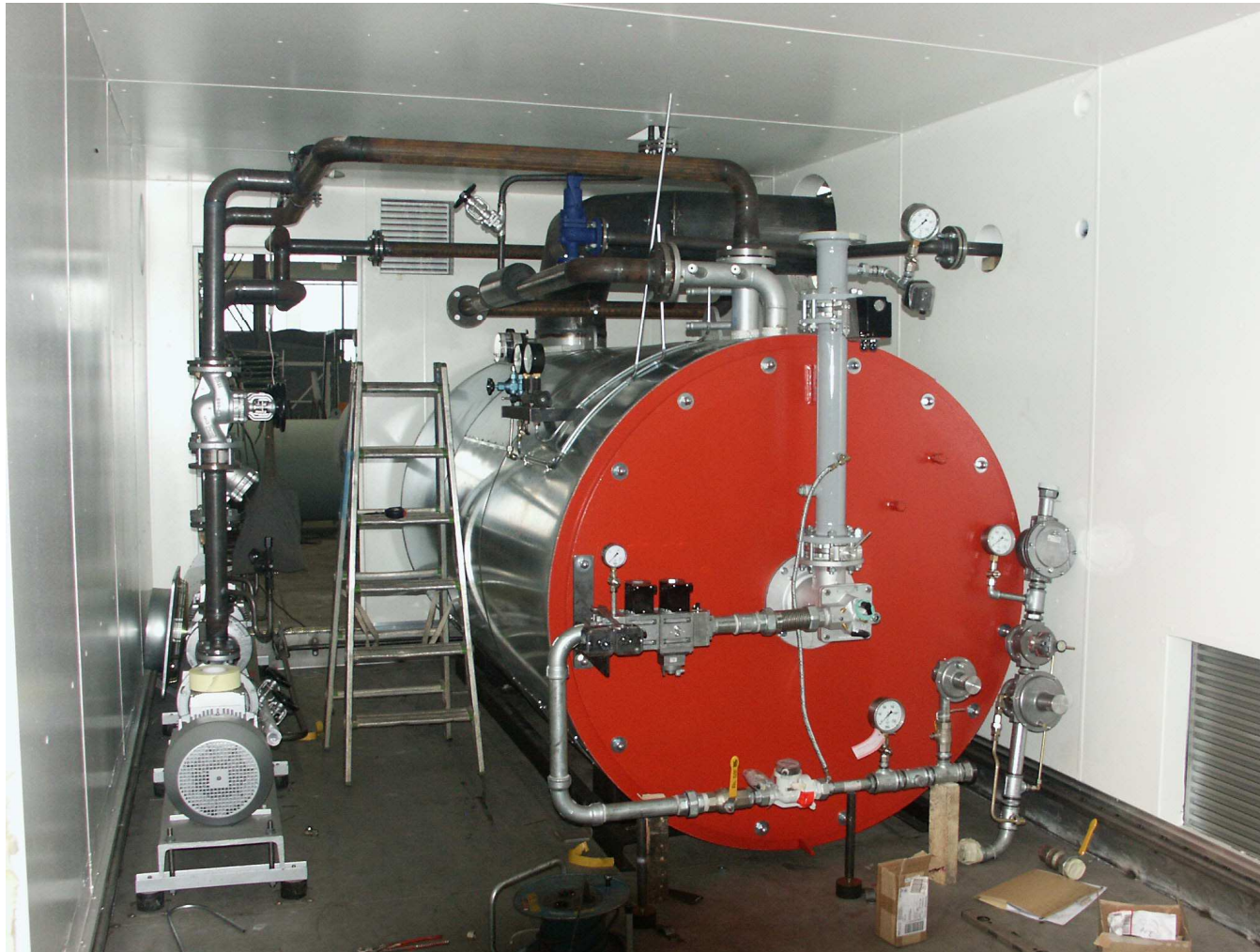
Erhitzer mit Gasbrenner und Umwälzpumpe in Container montiert Heater with gas burner und circulation pump assembled in a container
