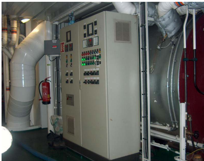
Proyecto K 0409 Ferry "Dueodde" para los Países Bajos, calentador de aceite térmico de una capacidad de 1.500kW y una caldera de gases de escape de 500kW
