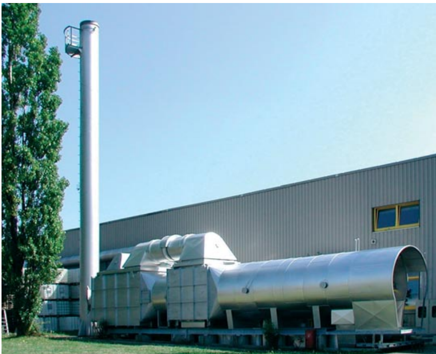
Thermische Abluftreinigungsanlage für 20.000 \text{ Nm}^3/\text{h} lösungsmittelbeladener Abluft
