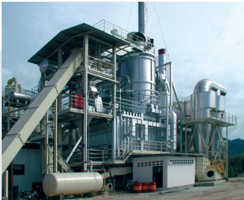
Feststofffeuerungsanlage mit Schleifstaubverbrennung, Leistung 11 MW, Thailand
