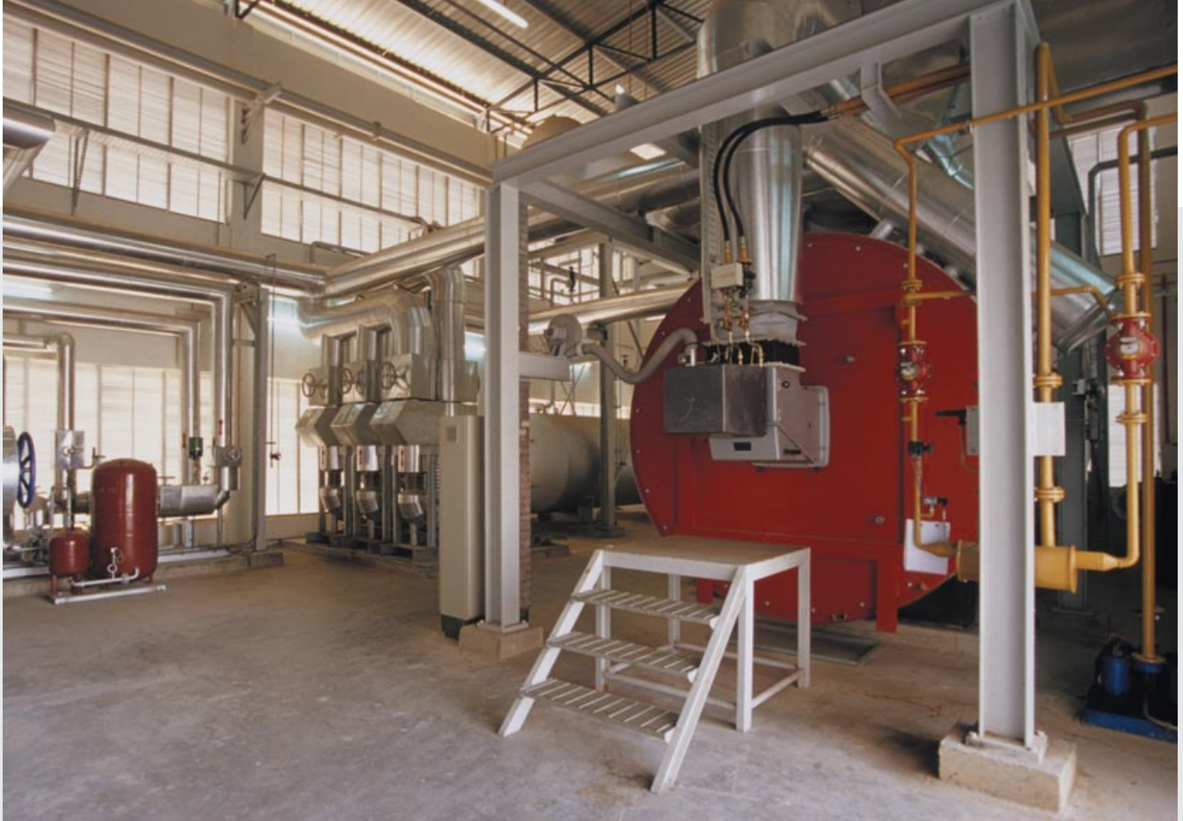
Thermalölerhitzer mit einer Leistung von 10 MW für die Herstellung von Spanplatten in Malaysia
